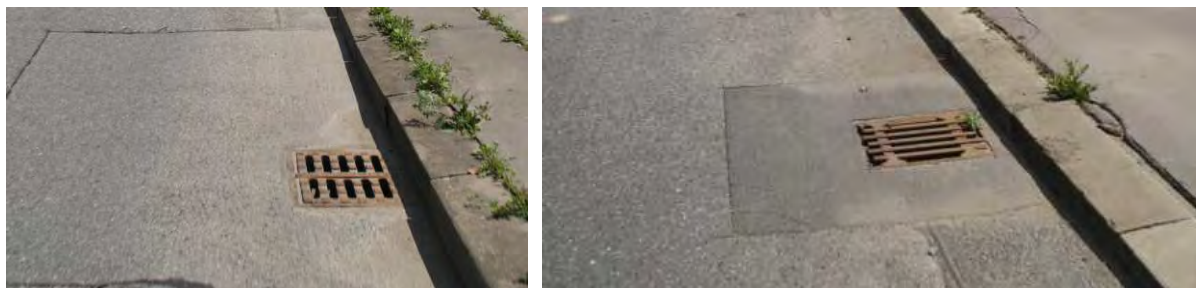
Vlevo nevhodné natočení mříží, vpravo vhodné (po úpravě)
